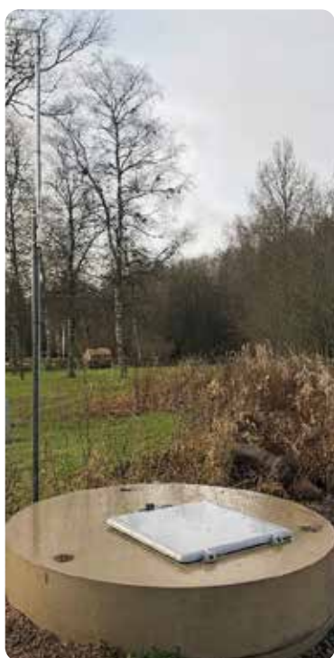
Vattenmätarbrunn med Lora antenn
